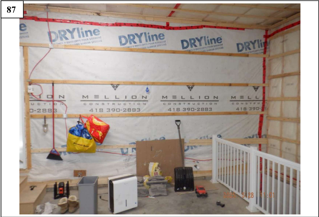
Garage : Séparation du garage non étanche à l'air
